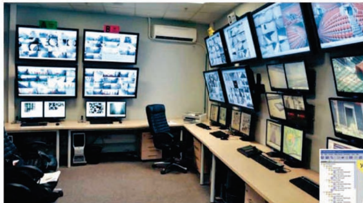
Poste de commande avec postes de travail MxCC et moniteurs d'image en 42"
